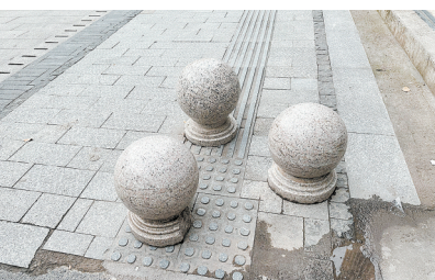
石墩占用盲道
