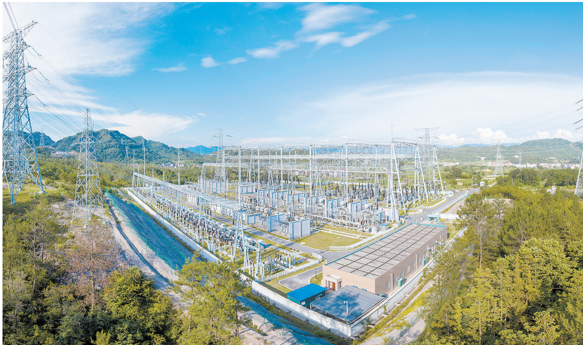
500千伏永康变电站
