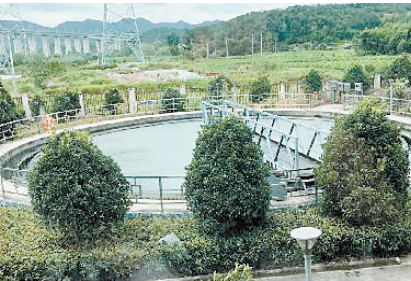
用于污泥浓缩的污水处理厂二沉池
