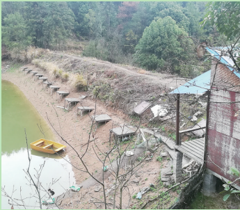
石柱镇洪福村上杨自然村： 大塘山塘坝顶、溢洪道违规搭建建筑物
