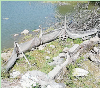
舟山镇外木坦村洋溪自然村： 清塘坑山塘私自加高溢洪道并设拦鱼网
