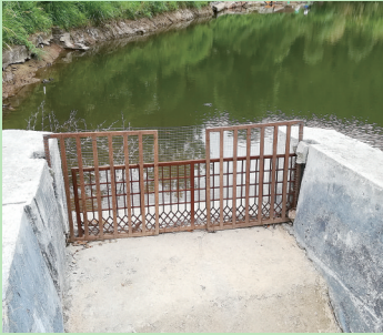
象珠镇柳墅村西寮自然村： 家塘山塘溢洪道违规设置拦鱼网
