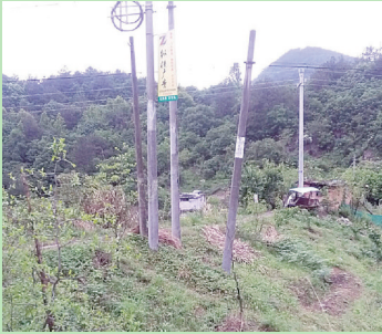
西城街道童宅村： 长塘山塘坝顶违规架设电杆、通信杆
