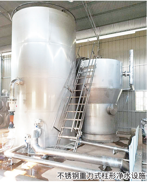
不锈钢重力式柱形净水设施
