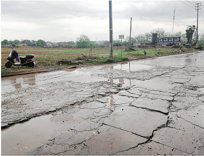
坑坑洼洼的路面。
