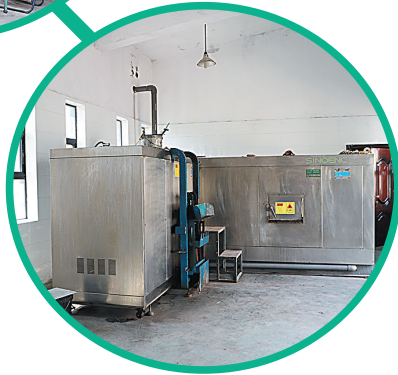
垃圾资源利用站处理设施
