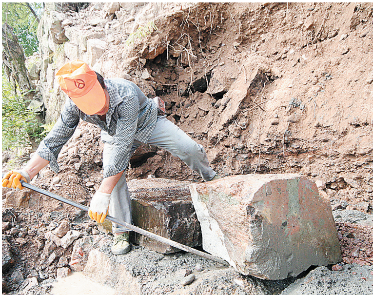
据市公路管理部门统计,19处遭水毁的公路挡墙、驳坎、边坡的修
