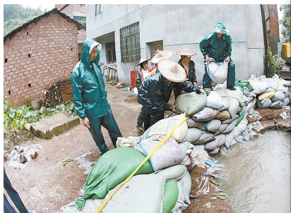
舟山镇党员干部在方山口村山体塌方现场抢险。(本报资料图片)
