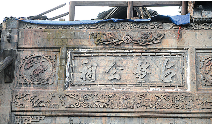
部分坍塌的门头
