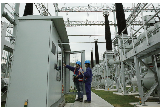
电力员工在500千伏变电站投运调试
