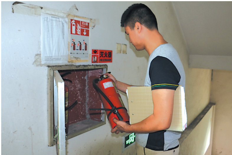
安全网格员在检查企业居住出租房消防设施
