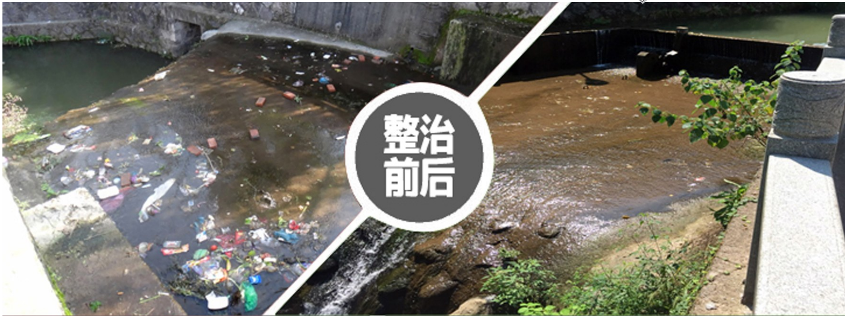
整治前 乌江溪独松村公厕旁拦水坝 河道垃圾散落。
