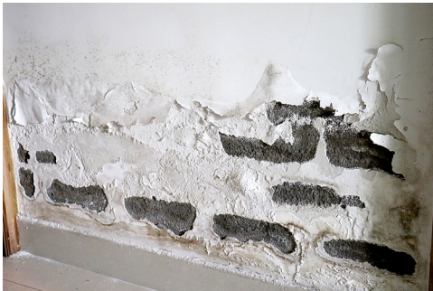
发霉、脱层的墙壁
